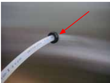
Abb.12: Beispielhafte geschützte Verlegung der Gasleitung in den Innenraum (Fasskühler, Theke)
